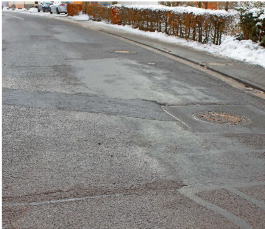
Loch geflickt: Am Freitag war die Buchwaldstraße wieder befahrbar. FOTO: FRANK FABER
